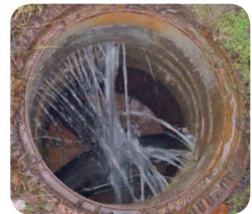
Grundwassereintritt im undichten Kanalschacht.
